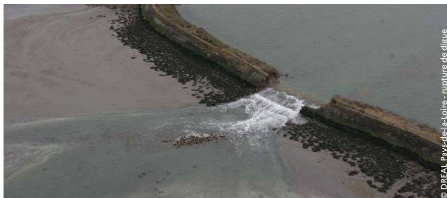
Rupture de digue
